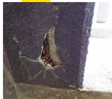
共用部の外壁の亀裂、鉄筋むき出し
