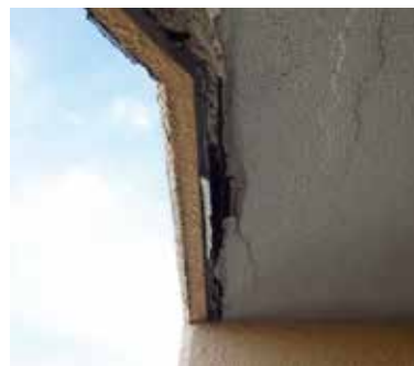
共用部天井、コンクリートのひび割れ
