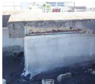
屋上コンクリートのひび割れ・傷み
