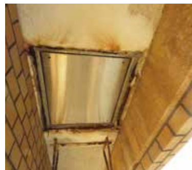
ベランダ天井（非常階段）のサビ
