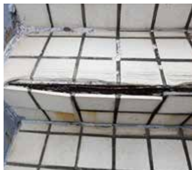
階段（タイル）の割れ
