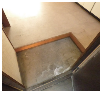
玄関土間はコンクリートがヒビ割れてきていました
