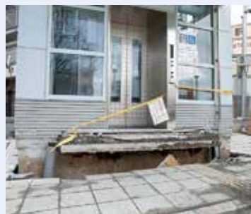
新浦安駅前広場にあったエレベーター。液状化の影響でまわりが沈下してしまっていました。
